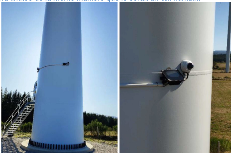
Figure 25 Système de surveillance sur un mât éolien
